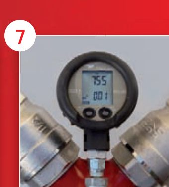
7 Actionner le manomètre et vérifier les valeurs de pression
