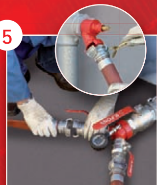
5 Raccorder les 2 flexibles souples DN45 des 2 entrées du collecteur aux 2 prises d'incendie à contrôler
